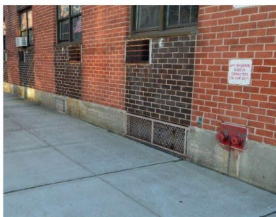
a. aberturas de ventilación cerca del nivel de la acera
