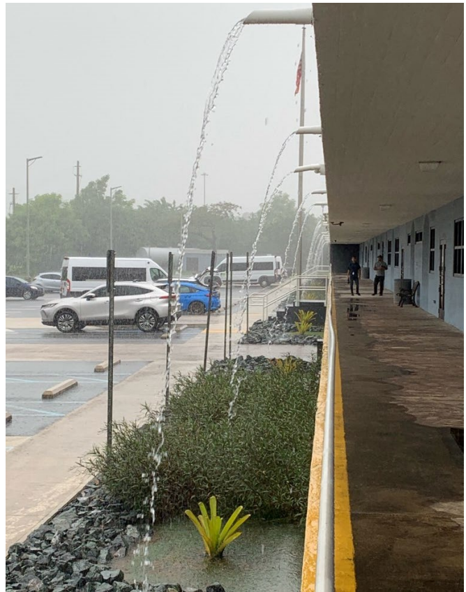
Ilustración 2-2. Cajas jardineras de biorretención en la instalación federal de la Administración de Servicios Generales (GSA, por siglas en inglés) en el municipio de Guaynabo durante una tarde lluviosa.
