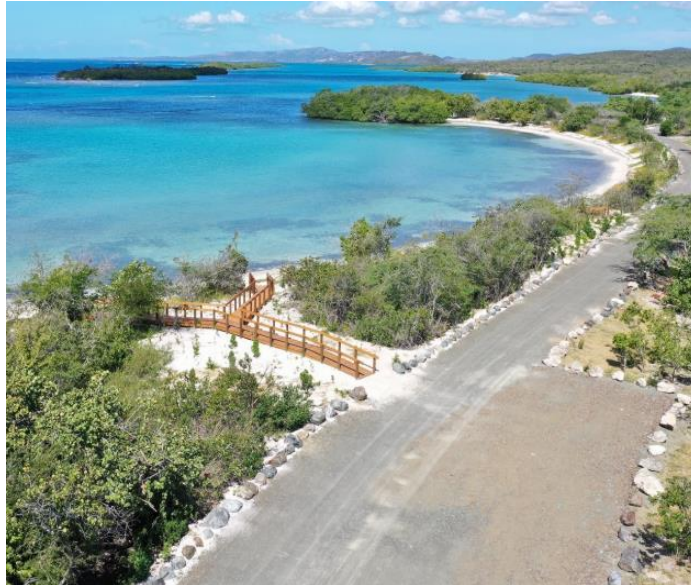
Ilustración 0-19: Instalación de paseo tablado y restricción de acceso en playa La Jungla (Protectores de Cuencas, usado con permiso)
