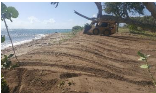
Ilustración 0-18: Construcción de montículos de arena en playa Tamarindo (Protectores de Cuencas, usado con permiso)
