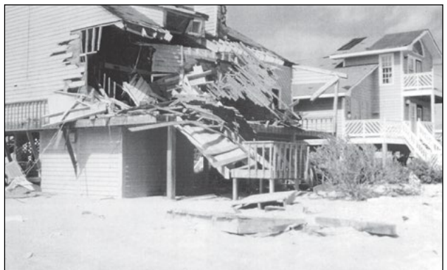
Imagen 2. Edificio bien ubicado que sufrió daños.
