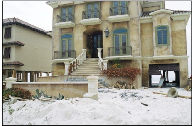
Las escaleras grandes y sólidas como estas bloquean el flujo debajo del edificio y son una violación a los requisitos de ausencia de obstrucciones del NFIP.
