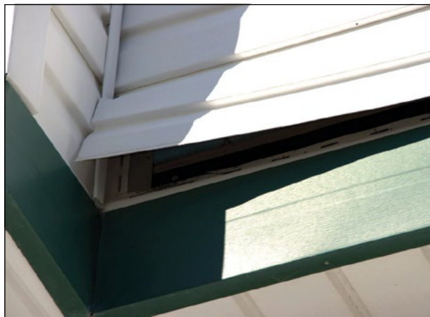
Imagen 4. La moldura para cables de servicios públicos fue sustituida por la faja inicial y el seguro inferior se cortó del panel. El revestimiento exterior se desprendió debido a la presión del viento.
