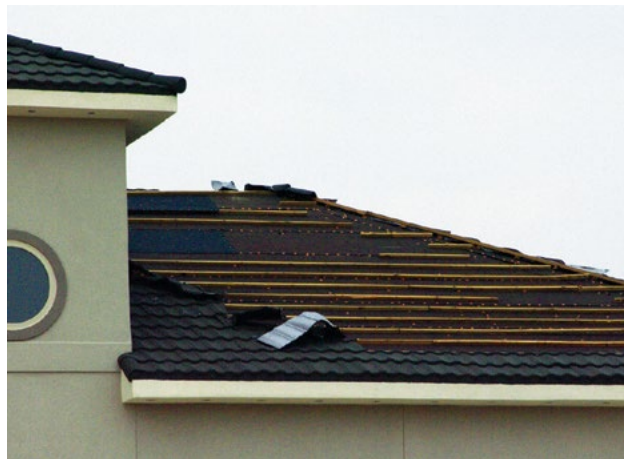
Imagen 7. Esta residencia tenía tejas en metal que simulaban la apariencia de tejas de arcilla. Por lo general, las tejas se desprenden de los listones, pero algunos de los listones también fueron arrancados por el viento
