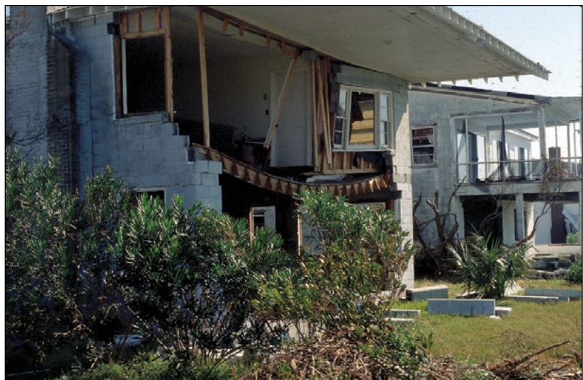
Figura 1. Las viviendas dañadas por una tormenta necesitan reparaciones, pero también ofrecen oportunidades para realizar renovaciones, adiciones y refuerzos. Verifique los reglamentos para daños sustanciales y mejoras sustanciales antes de comenzar cualquier trabajo.
