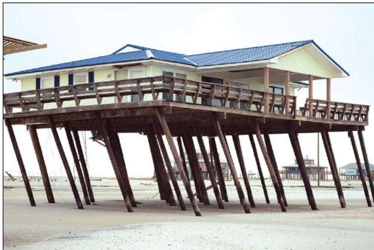
Imagen 1. Estructura a punto de colapsar debido a empotramiento inadecuado de los pilotes en la isla de Dauphin, Alabama.
