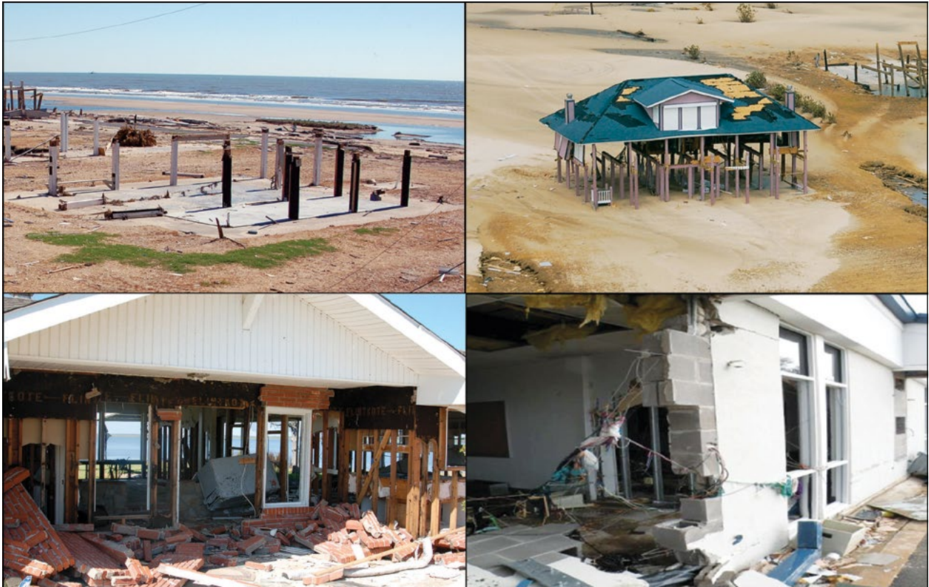
Imagen 5. Daños a edificios ocasionados por el huracán Ike. Las fotografías en la parte superior izquierda y parte superior derecha son de los edificios que estaban cerca de la costa del Golfo de México, sujetos a marejadas ciclónicas y olas grandes sobre el piso más bajo. La fotografía en la parte inferior izquierda es de un edificio cerca de la costa de la bahía de Galveston, sujeto a marejada ciclónica y olas pequeñas. La fotografía en la parte inferior derecha es de una escuela en Cameron Parish, Louisiana, aproximadamente a 1.3 millas de la costa del Golfo, pero que estuvo sujeta a marejada ciclónica y olas pequeñas.
