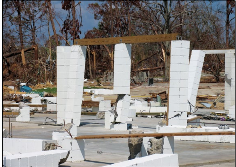
Imagen 2. Pilares rotos (Long Beach, Mississippi).
