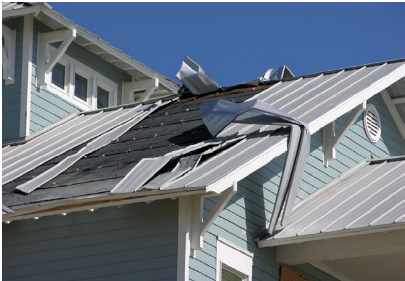
Imagen 2. Este sistema de paneles arquitectónicos tiene ganchos ocultos. Los paneles se soltaron de los ganchos. La primera hilera de ganchos (justo encima de la línea roja) estaba a varias pulgadas del extremo de los paneles. La primera hilera de ganchos debió haber estado más cerca del alero.
