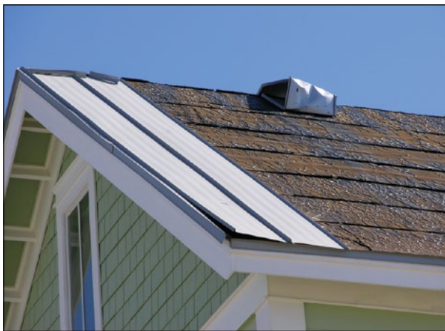
Imagen 3. Estos sistemas de paneles arquitectónicos tienen juntas que encajan. Un lado de la junta está fijado con un sujetador oculto. Aunque el viento arrancó una gran cantidad de paneles, no arrancó la capa base
