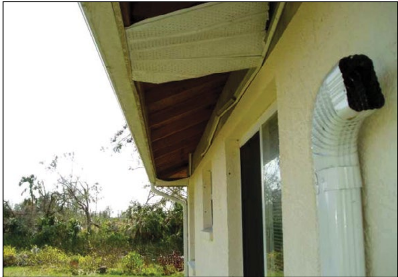
Imagen 1. Falta de material en el soffito.
