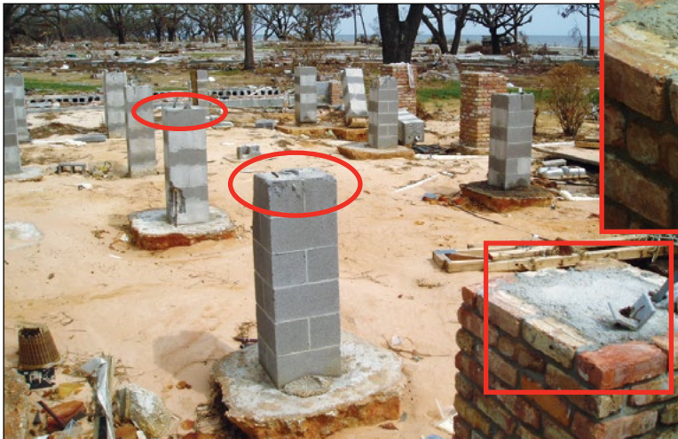
Imagen 3. Falla de las conexiones entre pilares y vigas debido a la acción del oleaje y las inundaciones que actúan sobre el edificio elevado (Long Beach, Mississippi).
