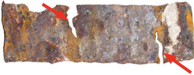
Imagen 3. Corrosión significativa del sujetador provocó que el ladrillo en la estación de bomberos fallara, aunque el edificio no está cerca de la costa. Observe que falta metal en la mitad del ancho del sujetador en dos puntos específicos (flechas rojas). El extremo izquierdo del sujetador quedó incrustado en la pared de refuerzo de bloques de hormigón. El extremo derecho es el punto donde falló el sujetador en tensión, lo que dejó una parte del sujetador incrustada en el ladrillo colapsado.
