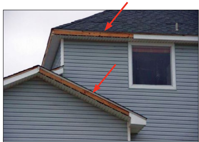
Imagen 7. Pérdida de la cubierta de la faja expone los extremos del sofito de vinilo a la entrada directa de la lluvia impulsada por el viento.
