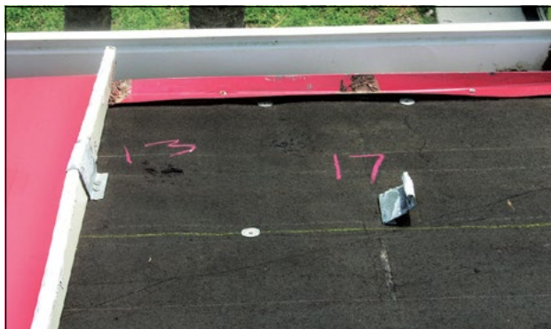
Imagen 4. Estos ganchos de alero estaban muy lejos de los extremos del panel. El gancho de la izquierda estaba a 13" del borde de la cubierta. El otro estaba a 17" del borde. Hubiera sido prudente instalar los ganchos dobles a lo largo del alero.
