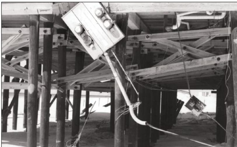
Líneas eléctricas y caja eléctrica desprendidas por las fuerzas del huracán.
