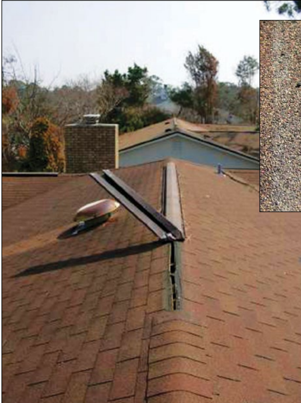
Imagen 8. Esta rejilla de ventilación de metal de la cresta estaba fijada con clavos de techo con mucha separación.
