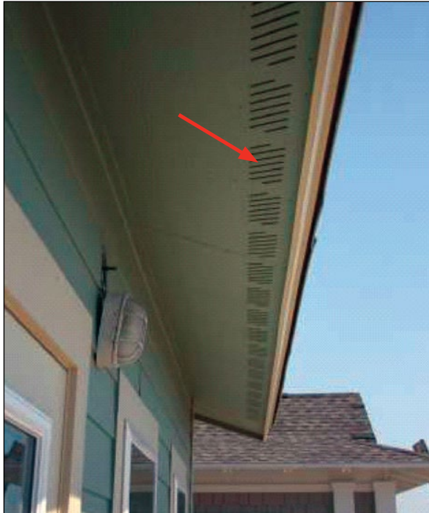
Imagen 6. Soffito de cemento de fibra con ranuras de ventilación (flecha roja).
