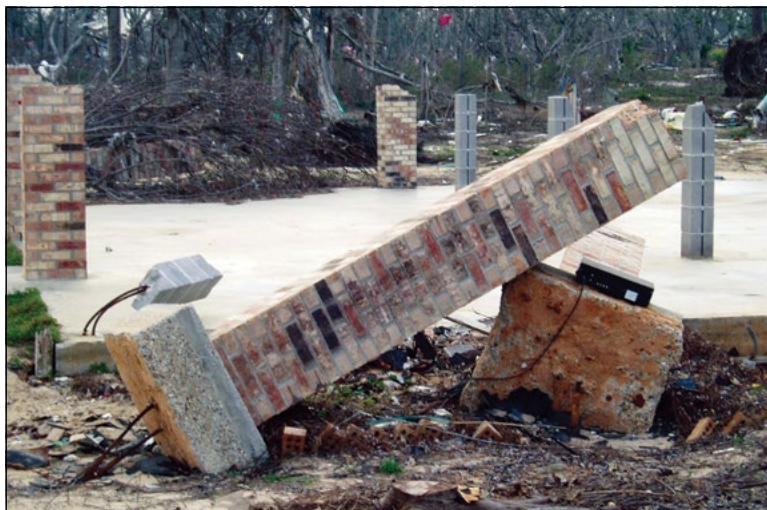
Imagen 2. Comparación del rendimiento de cimientos de pilares. Los pilares sobre zapatas discretas (en primer plano) fallaron al rotar y volcarse mientras que los pilares sobre zapatas más sustanciales (en este caso una base de cemento) sobrevivieron (Pass Christian, Mississippi).
