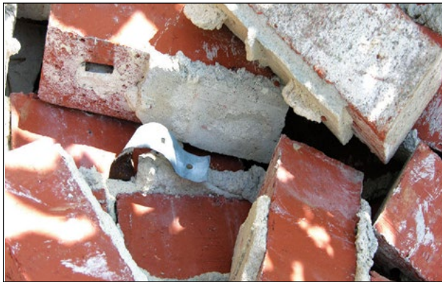
Imagen 4. Este sujetador quedó incrustado en la junta de cemento mientras el clavo de tallo liso fue arrancado del montante.
