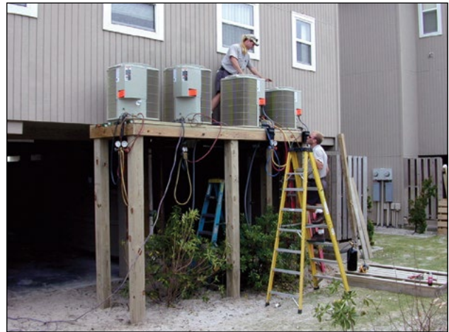
Compresores de aire acondicionado elevados.
