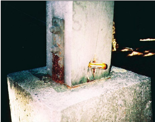
Deterioro de madera en la base del poste de madera con soporte de hormigón.
