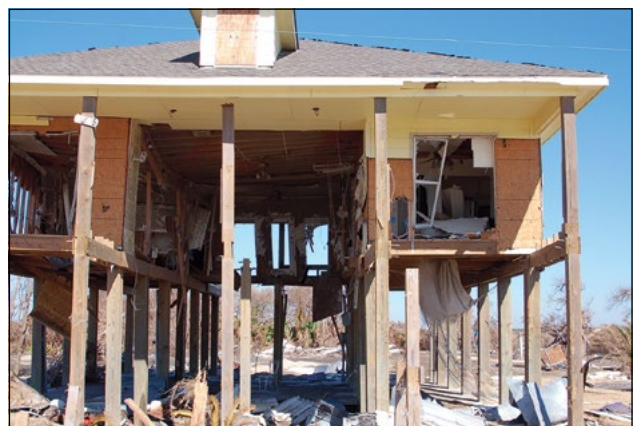
Imagen 2. Península Bolívar, Texas, vivienda en la Zona V construida con el piso más bajo (parte inferior de la viga del piso) en el BFE (línea entrecortada). El nivel de cresta de ola estimado durante el huracán Ike (línea sólida) fue entre 3 y 4 pies sobre el BFE en esta ubicación.
