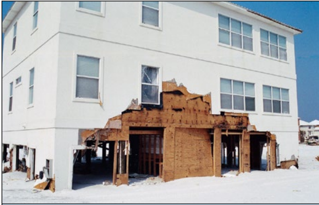
Imagen 4. El revestimiento exterior del edificio se extendía hasta abajo y sobre la pared desprendible. La falta de una separación limpia permitió que los daños continuaran hasta arriba al fallar la pared desprendible.
