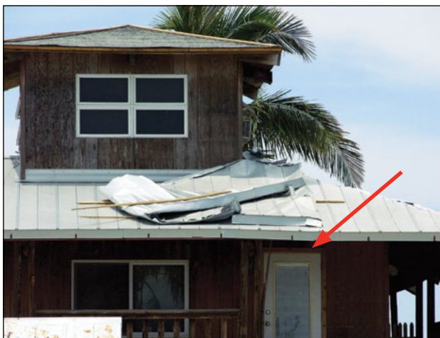
Imagen 5. Los paneles fueron arrancados del techo superior y cayeron en el techo inferior de esta casa. El techo superior con tejas de asfalto se había recubierto con paneles 5V rizados atornillados a las alfajías. El fallo se debió a la fijación inadecuada de las alfajías (que tenían clavos muy separados) al revestimiento. Observe que el viento arrancó el tapajuntas del filo del techo inferior.
