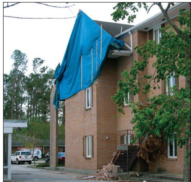
Imagen 2. La parte superior del revestimiento de ladrillo en este edificio de apartamentos colapsó. Los vehículos y peatones que pasen cerca del área de la pared dañada corren el riesgo de sufrir daños o lesiones si los pedazos de pared que quedan colapsan durante tormentas subsiguientes.
