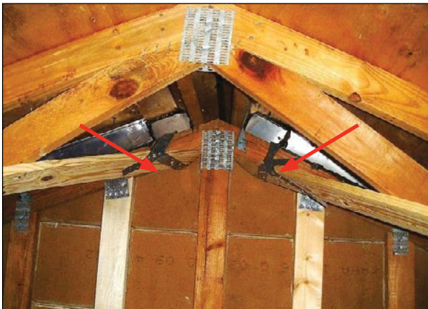
Imagen 12. Tapones de metal (flechas rojas) en las rejillas de ventilación del extremo inclinado del hastial.
