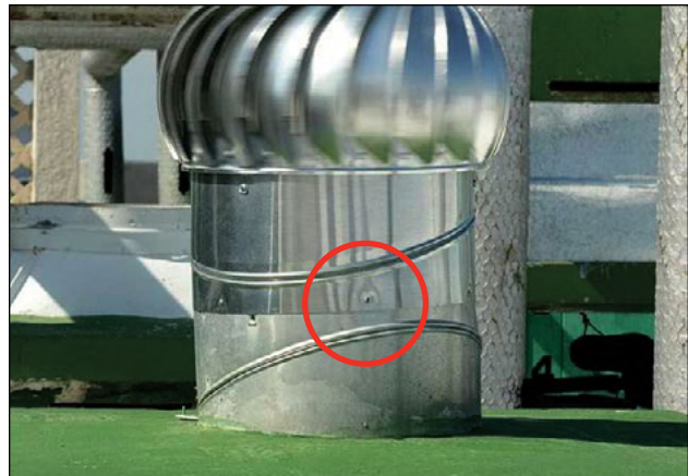
Imagen 13. El cabezal de la turbina está fijado al tubo de base con perforaciones al metal. Se deben añadir tornillos de metal enchapados para reforzar la conexión.
