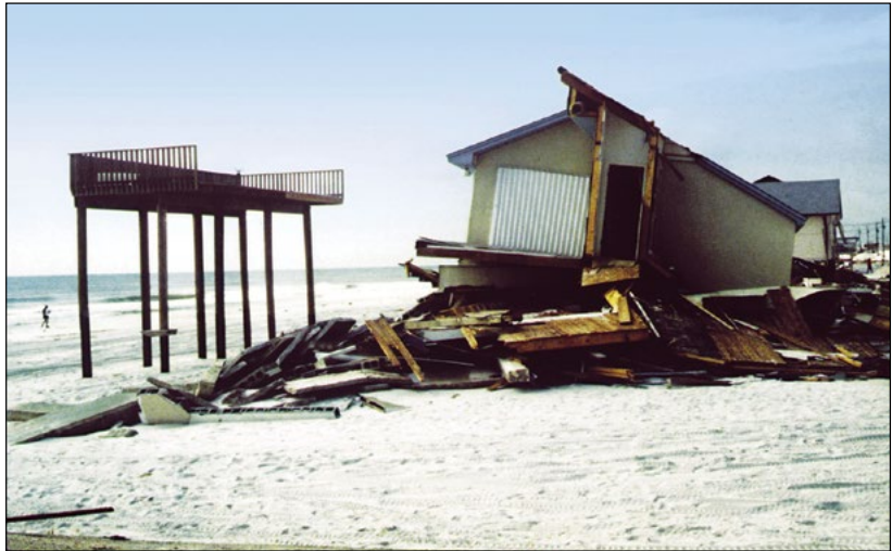
Daños causados por el huracán Opal en Florida. Esta cubierta fue diseñada para cumplir con los requisitos de la Línea de Control de Construcción Costera (CCCL) del estado de Florida. La casa fue construida antes de la implantación del CCCL y no cumplía con estos requisitos.
