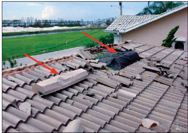
Imagen 11. En esta fotografía se muestran dos rejillas de ventilación en el borde de la cresta. La rejilla que está cubierta con fieltro de techo se volteó hacia arriba y permitió que entrara una cantidad sustancial de agua a la residencia. Hubo que reemplazar alfombras, gabinetes de cocina y una gran cantidad de tabla de yeso debido a toda el agua que entró
