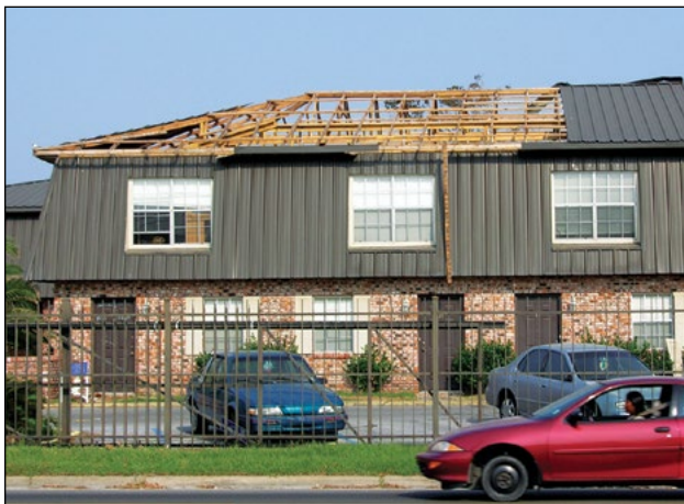
Imagen 6. Las alfajías arrancadas hicieron que estos paneles fallaran progresivamente. Las alfajías fueron instaladas directamente sobre las cerchas. En un ensamblaje como este sin cubierta, no hay oportunidad para incorporar una capa base. Al perder esos paneles, el agua de lluvia entró fácilmente al edificio
