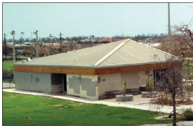
Imagen 1. Este sistema de techo estructural con junta de plegado saliente sobrevivió al huracán Andrew (Florida, 1992), pero algunos tapajuntas del filo fueron arrancados. La velocidad estimada del viento fue de 170 mph (ráfaga pico, a 33 pies de la Exposición C).
