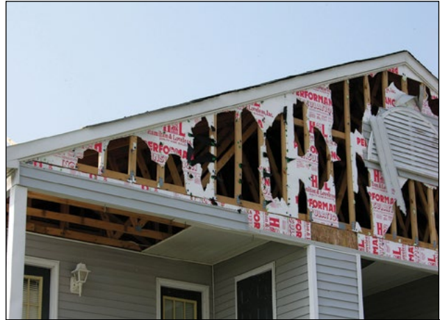
Imagen 7. El revestimiento exterior de vinilo en este hastial fue instalado sobre un aislamiento de espuma plástica. Sin el revestimiento de madera, aumentan las presiones del viento sobre el vinilo. Además, si el viento desprende el revestimiento exterior, el aislamiento de espuma estará muy vulnerable y podría desprenderse también. Al perder el aislamiento de espuma, la lluvia impulsada por el viento puede entrar libremente al ático, saturar el aislamiento del techo y provocar que colapse.
