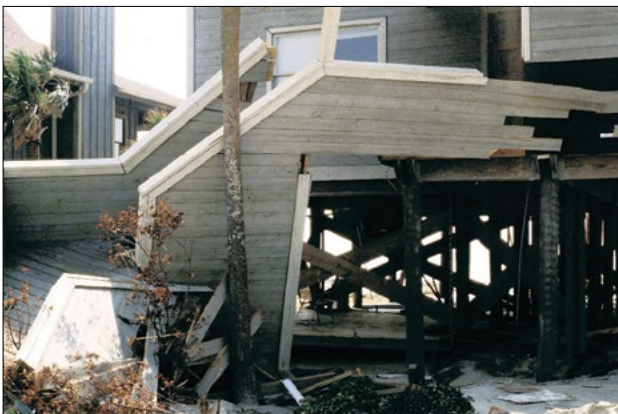
Los pasamanos en estas escaleras estaban encerrados con el revestimiento exterior, lo que presenta un mayor obstáculo para el flujo del agua de inundación y contribuyen a los daños de inundación mostrados aquí.
