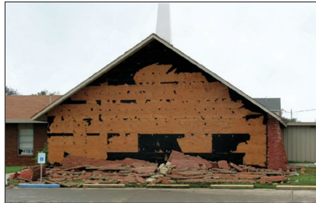
Imagen 1. Fallos en el revestimiento de ladrillo sobre madera contrachapada. Muchos de los sujetadores aún están pegados a la superficie, pero varios de los sujetadores fueron arrancados de la superficie y las amarras están incrustadas en el revestimiento colapsado. Velocidad del viento estimada: 107 mph (ráfagas pico, Exposición C, a 33 pies).
