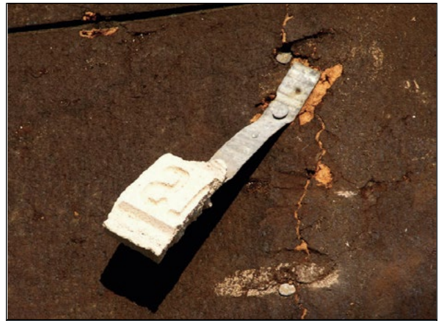
Imagen 6. Este sujetador estaba incrustado en el cemento, pero el sellador no fue suficiente.
